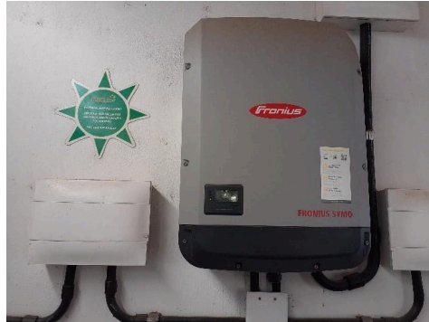
Figura 8. Conversor de energia solar/rede elétrica.
